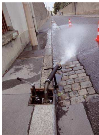
Bouche de lavage utilisée avec un « col de cygne »
