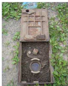
Bouche Incendie de 80 mm à tenons
